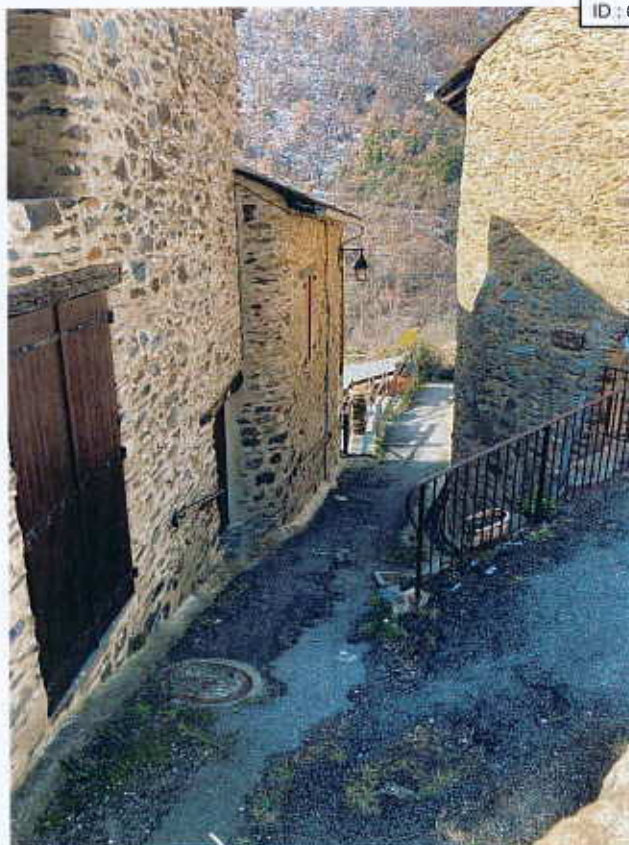
Figure 7 : Exemple de voirie à reprendre (Carrer del Barzet)
